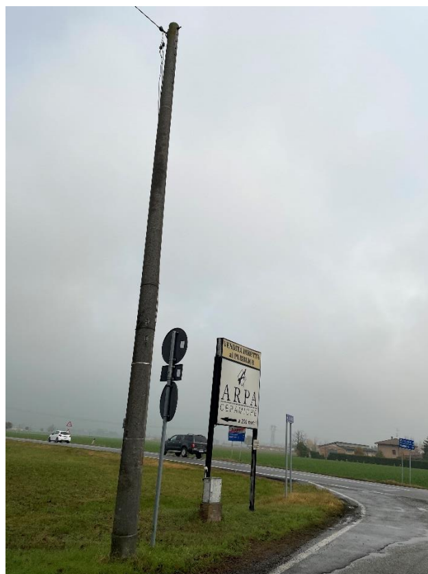
Palo Enel interferente da spostare
